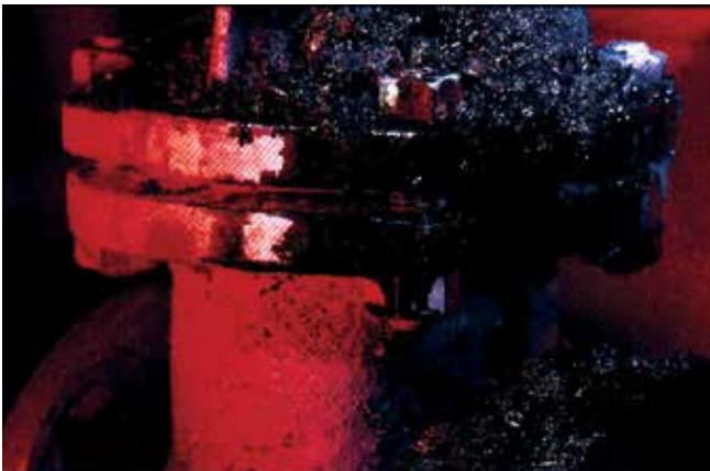
Bei Verwendung von Wärmeträgerölen mit hohem Dampfdruck kann es an Steuerventilen und Rohrflanschen zu starker Schlamm- und Schmutzbildung kommen.
